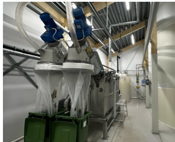
Avloppsreningsverk i Tandsbyn.
