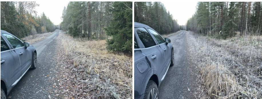
Figur 3. Foton på vägdike som visar sträcka där vatten rinner över slänt in i skogen.
