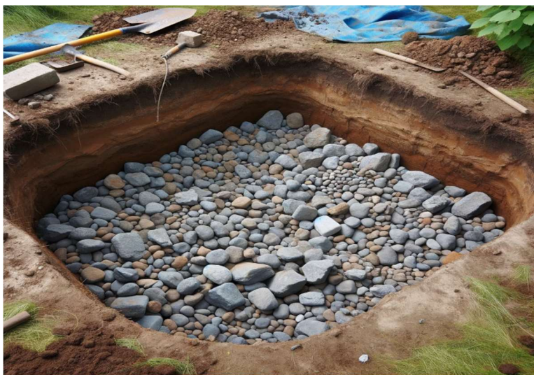
Figur 13. Stenkista grop med makadam för fördröjning och rening av dagvatten.
